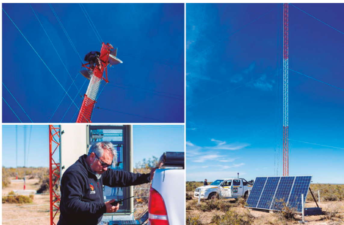
Izquierda arriba: operario terminando de instalar la antena en el punto central de la Península Valdés. Izquierda abajo: técnico controlando la intensidad y calidad de la señal de conectividad. Derecha: antena lista y transmitiendo. Nótese los paneles solares que alimentan energéticamente a la antena y demás recursos tecnológicos asociados.
